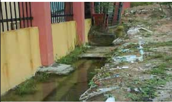
Saliran yang tidak mencukupi Inadequate drainage
